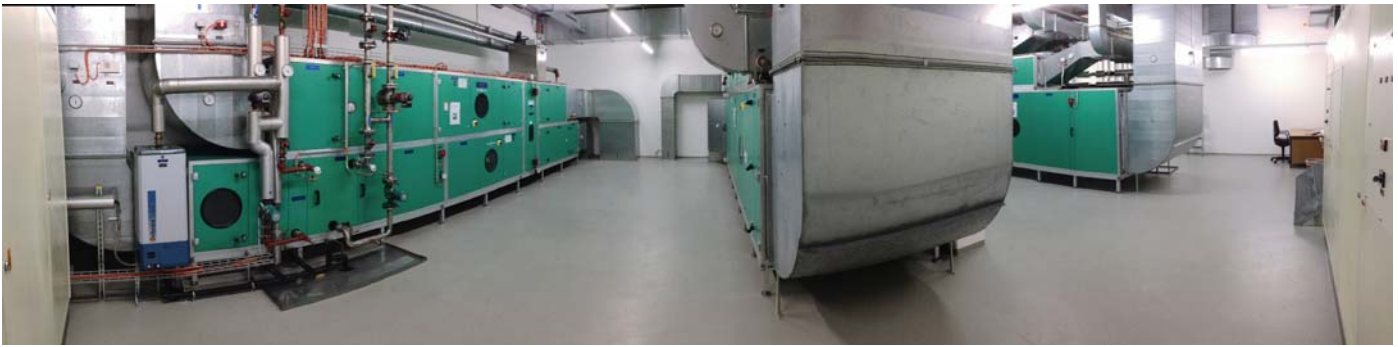
Lüftungszentrale eines der Gebäude der Axpo.
