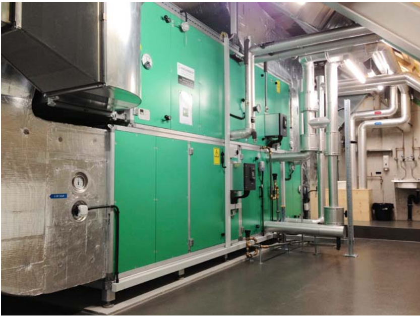
Monoblock einer Lüftungsanlage der Axpo.
